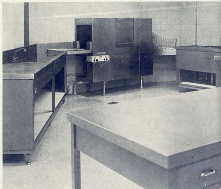
Central de lavado
